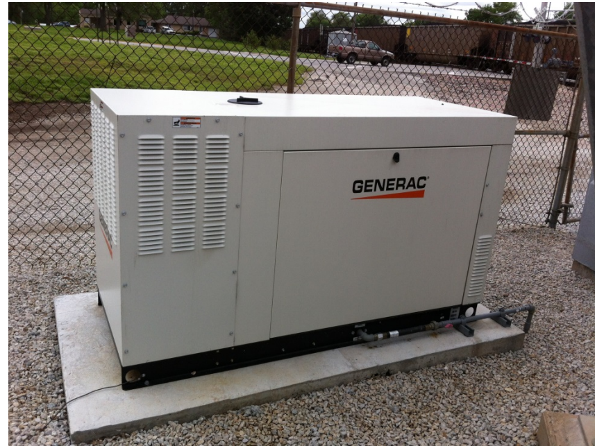
New Generac QT025A 25kW
